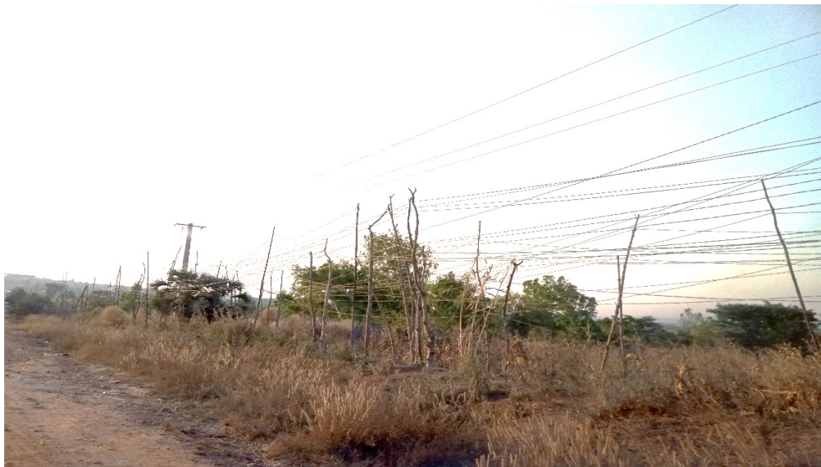
Photo 11 : Branchement anarchique à l'énergie électrique (Abouda)
